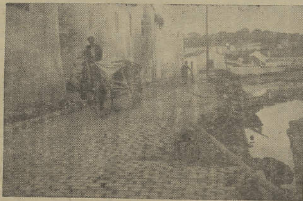
Um aspecto da Rua dos Pelames com a muralha desmoronada. O poste eléctrico que se vê ao fundo, já foi arrastado, bem como quase metade do pavimento da rua
